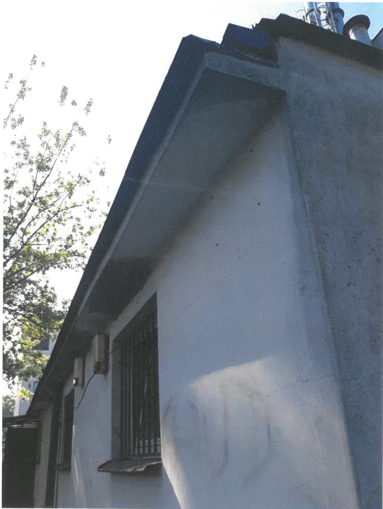
Zdjęcie nr 6. Aktualne zamocowanie rynny (w dalszej części widoczny fragment elementu nr 7 - rura spustowa)
